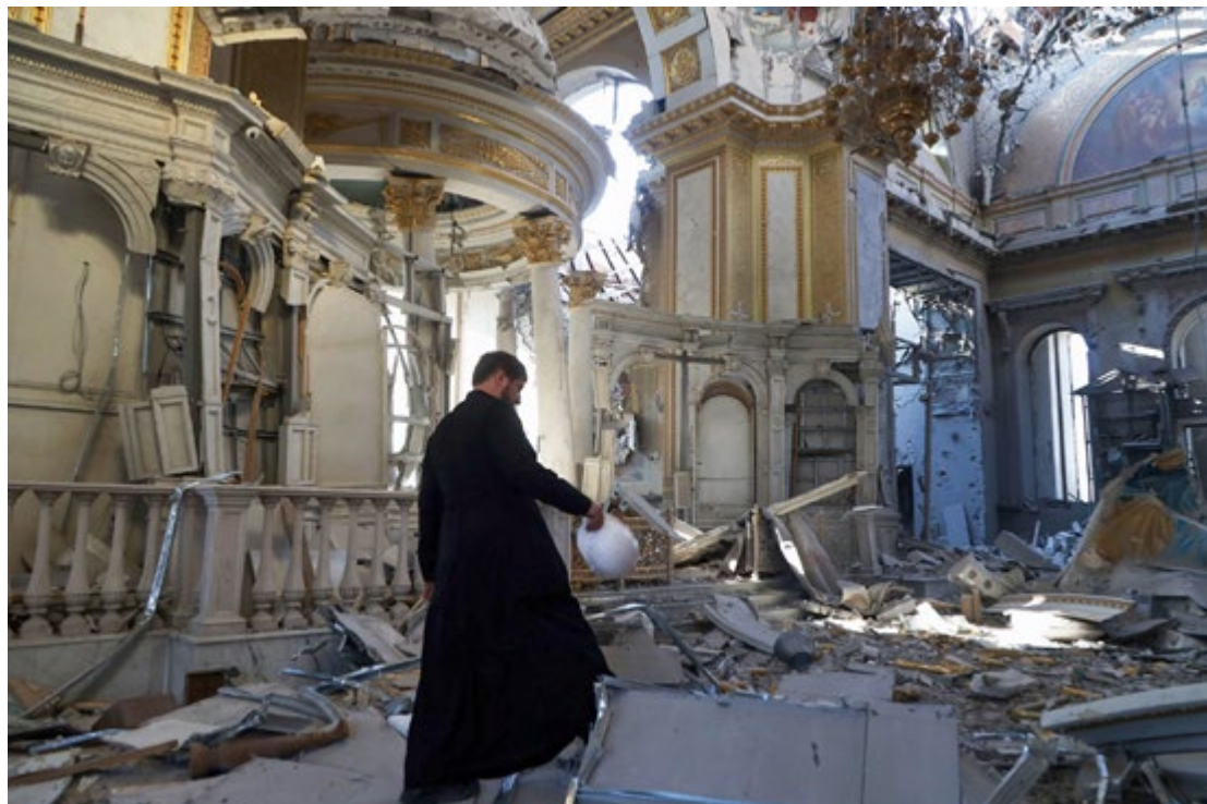
Zniszczenia we wnętrzu katedry Przemienienia Pańskiego w Odessie, fot. domena publiczna
